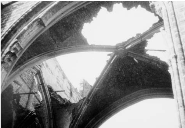
Abb. 8: Durch das mittlere Südfenster des Langhauses ist die stark beschädigte Gewölbekappe des Südseitenschiff-Mitteljochs und das teilweise eingestürzte Kurze Joch zu erkennen. Foto vor 19. Februar 1946.
