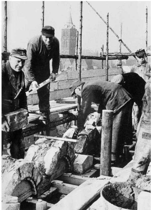
Abb. 13: Über den Arkaden des Westwerk-Galeriegeschosses wird die Wand aufgemauert, 35 cm höher als ursprünglich. Foto vermutlich vom Herbst 1949.
