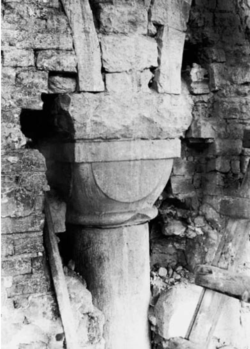
Abb. 11: Mit den beginnenden Wiederaufbauarbeiten am Westwerk wurden die originalen Kapitelle in der Wand aufgedeckt, die sich schon auf Fotos seit 1945 schemenhaft abzeichneten. Das Foto entstand 1949.
